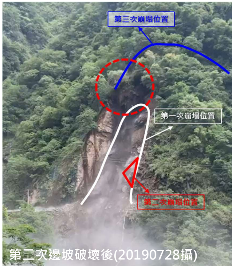
台7線32K+500第三次崩塌事件初始位置與第一次、第三次事件關係圖
